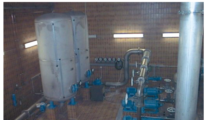
Druckhöhungsanlage im Rohrkeller des Hochbehälters
