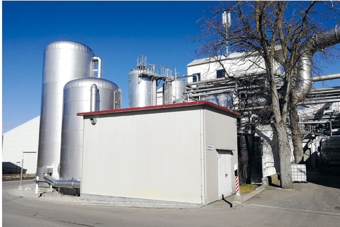
Pufferspeicher und Pumpenhaus auf dem Firmengelände der Firma Berndt in Oberding
